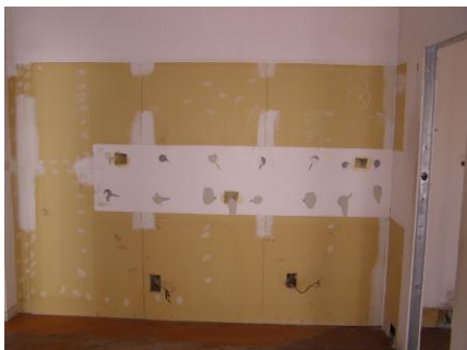
壁部分が劣化している
